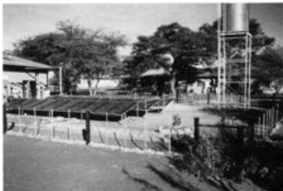
30 Sonnenkollektoren - erbaut 1986 Gebäude links: neue Küche andere Gebäude: Internaträume für die Mädchen Foto: Theo Junkley
